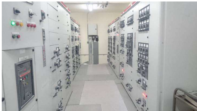
Ηλεκτρικός Υποσταθμός Γ.Ν. «Γ. Γεννηματάς»
