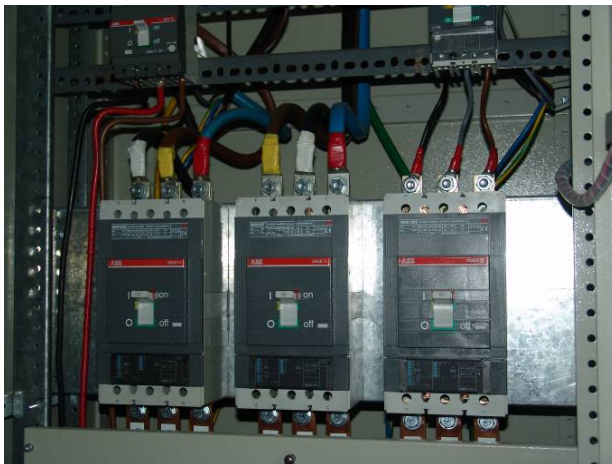
Ηλεκτρικός Υποσταθμός Γ.Ν. «Γ. Γεννηματάς»
